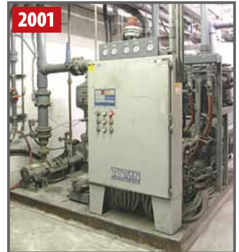
ADVANTAGE 50 TON CHILLER
