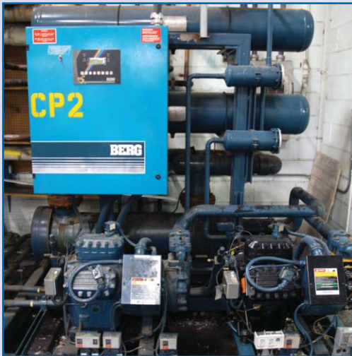
BERG 80 TON CHILLER
